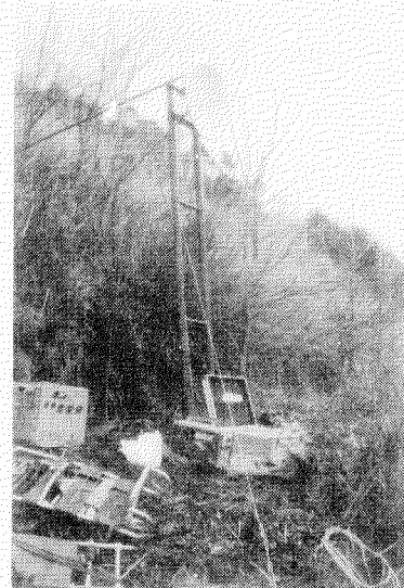
図4.3.25 送信設備全景
