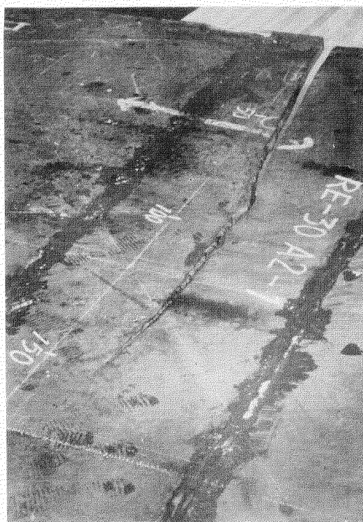
写真 12 脆性クラック伝播状況 (3)
