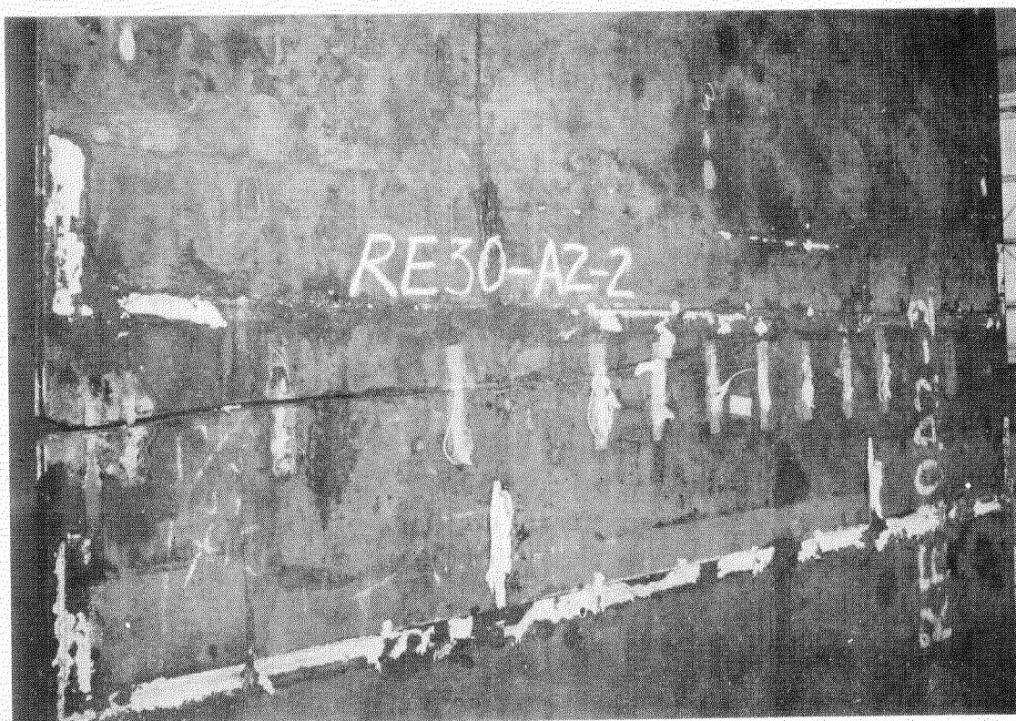
写真1.3. 脆性クラック伝播状況 (4)
